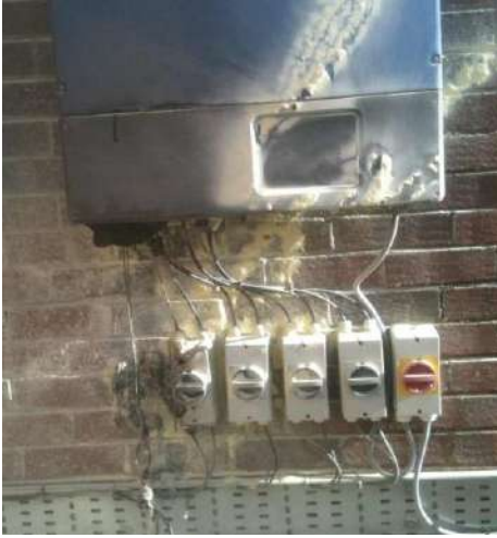
Sol taraftaki DC izolatörünün tamamen eksik olduğu, yangın nedeniyle yok olduğu ve yukarıdaki bitişik izolatör ve invertörün ikincil hasara uğradığı yerel yangın
