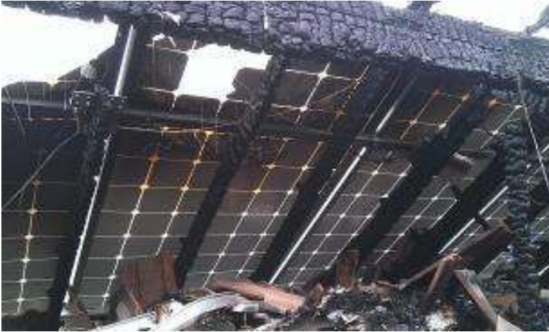
PV sisteminin parçalarının sağlam olduğu yanmış çatı örneği
