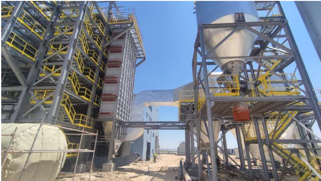
Şekil 4: Biyokütle Tesisleri Dış Merdiven
