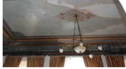
Şekil 2. Haydarpaşa Garı yangını sonrasında söndürme çalışmaları sonucu hasar gören kalem işi tavan (Fotoğraf: İstanbul V No'lu KTVK Bölge Kurulu Müdürlüğü Arşivi)
