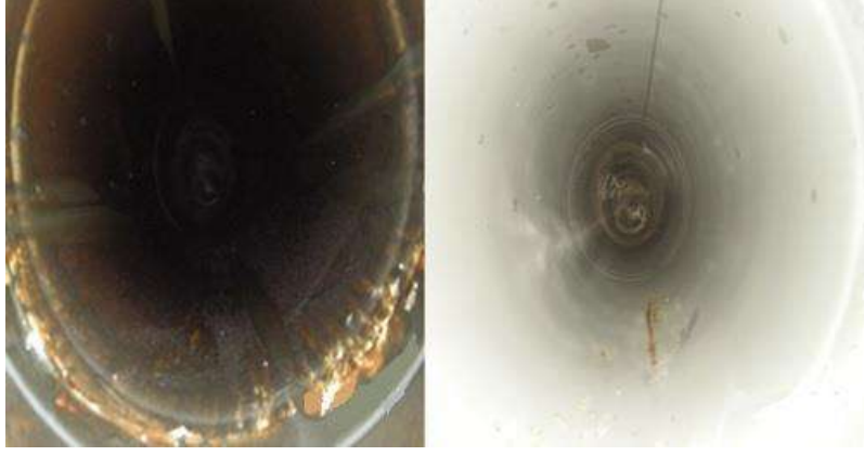
Şekil 12. Temizlik öncesi ve kimyasal köpük uygulaması ile temizlenmiş dikey kanal
