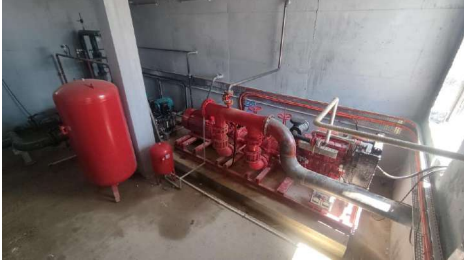
Şekil 7: Biyokütle ve Biyogaz Tesislerinde Yangın Pompa Grubu
