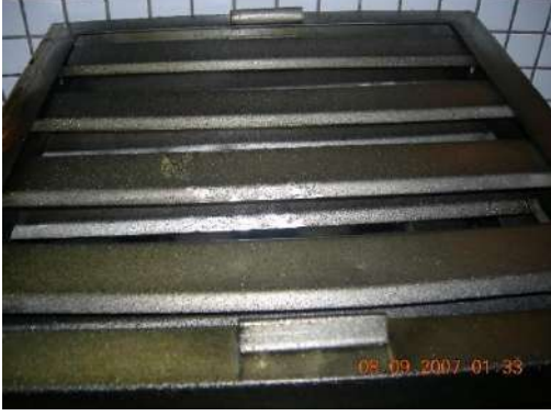
Şekil 6. Temizlenmesi gereken yağ tutucu filtre
