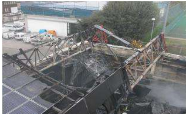
Şekil 4. Fotovoltaik panellerin yanması ve yapıya etkisi
