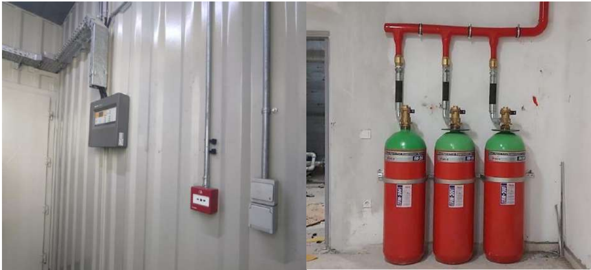
Şekil 12: Biyokütle ve Biyogaz Tesisleri FM 200 Söndürme Sistemleri
