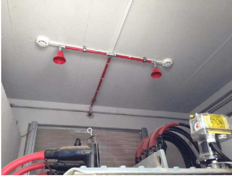
Şekil 11: Biyogaz ve Biyokütle Tesislerinde KKT Söndürme Tüpleri
