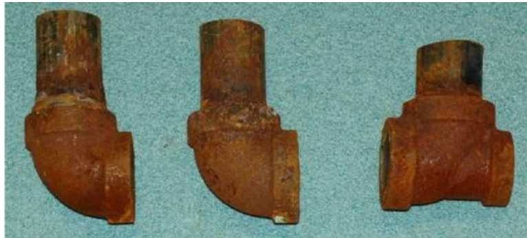
Şekil 1. Islak borulu sistemde çelik yağmurlama boru dişli bağlantılarından su sızıntısının oluşturduğu genel korozyon. (Kaynak: FM Global)
