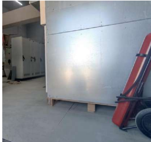
Şekil 10: Biyogaz ve Biyokütle Tesislerinde Karbondioksit ile Söndürme Sistemleri
