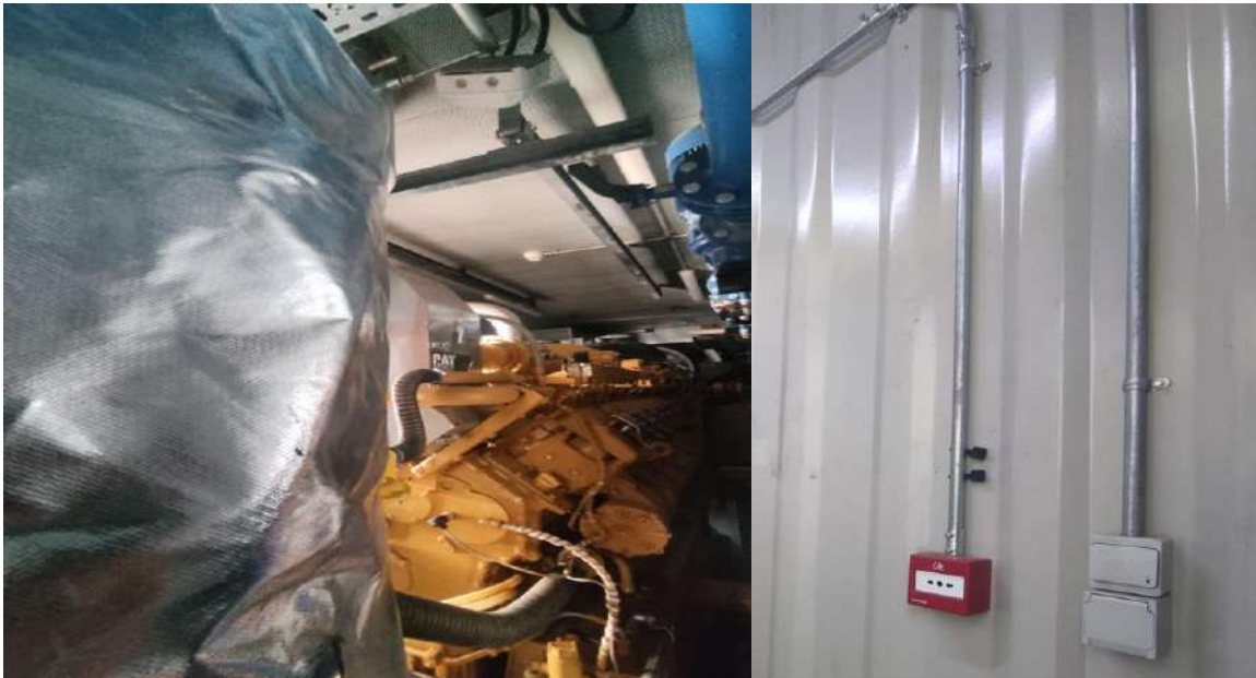
Şekil 5: Biyokütle ve Biyogaz Tesislerinde Erken Uyarı Sistemleri ve Uyarı Butonları
